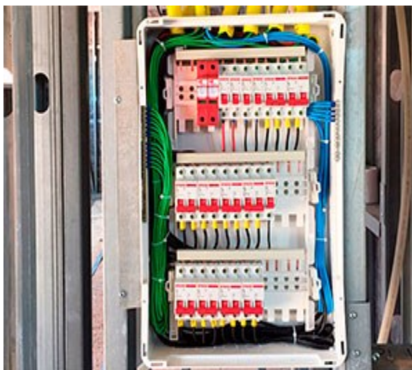
Figura 33 – Exemplo de quadro de distribuição.
